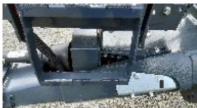
geschützt verbaute Pumpe
